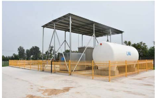
种源场锅炉煤改气设备
