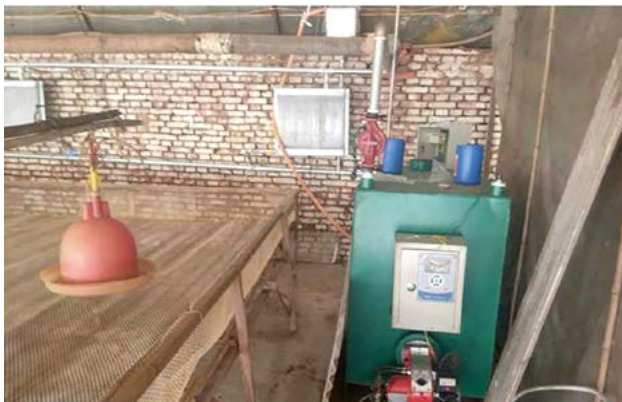
合作养殖户甲醇新能源锅炉
