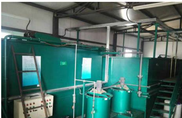
污水处理设施
