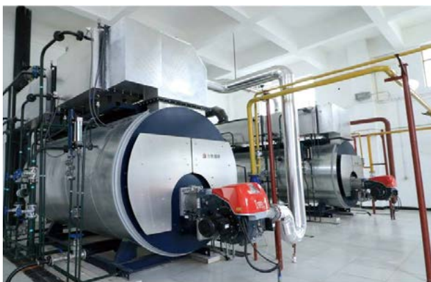
屠宰加工厂锅炉煤改气设备
